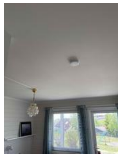
Bilde 4 Detektor på soverom er plassert innenfor regelverket, men anbefaler at den plasseres mer sentrert til rommet.
