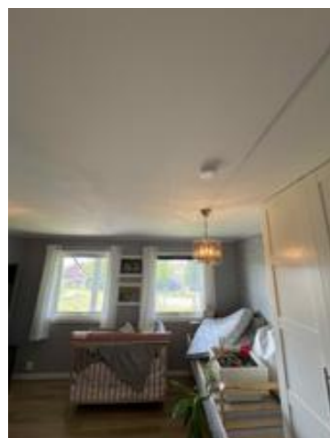
Bilde 3 Detektor på soverom er plassert innenfor regelverket, men anbefaler at den plasseres mer sentrert til rommet.
