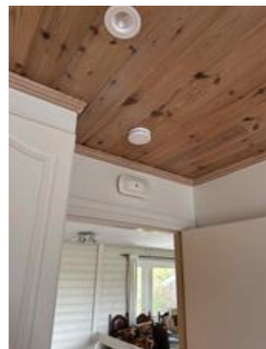
Bilde 2 Detektor på kjøkken er plassert kun 27cm fra nærmeste vegg.
