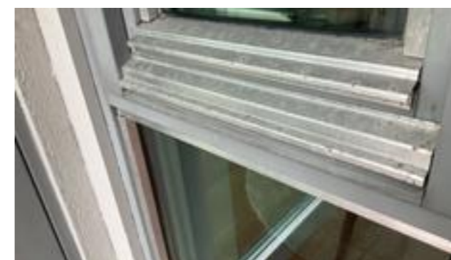
Oppsprikning/værslitasjer på enkelte vinduer.
