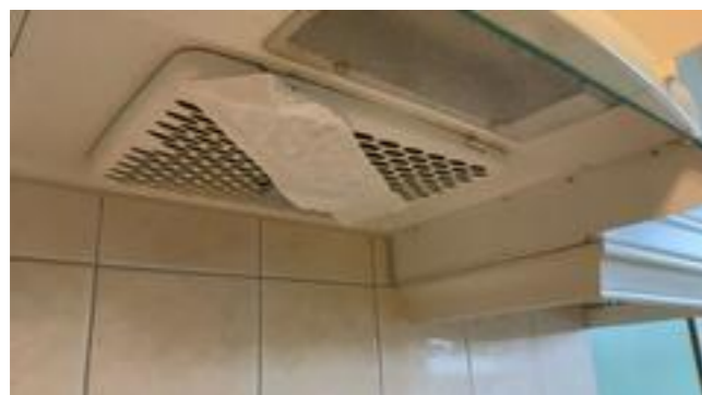
Ventilator funksjonstestet med papir.
