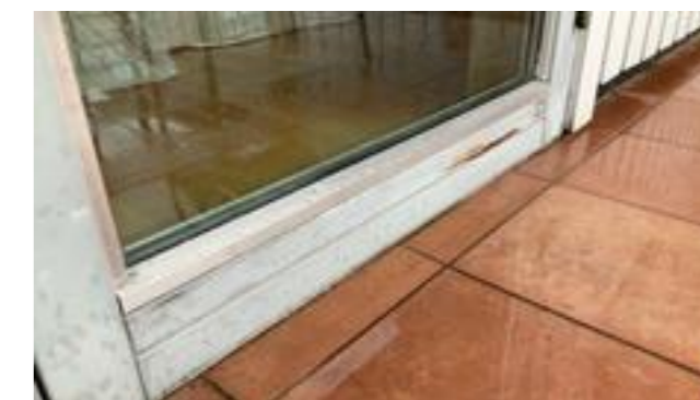
Værslitte/malingsavflassing på balkongdører.
