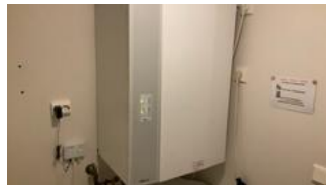
Motor for ventilasjonsanlegget.
