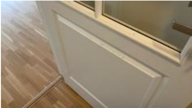
Avflassing på enkelte dørblad.
