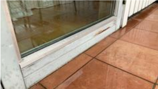
Værslitte/malingsavflassing på balkongdører.
