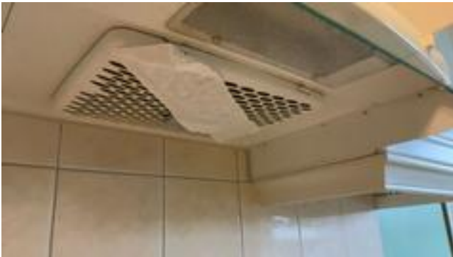
Ventilator funksjonstestet med papir.
