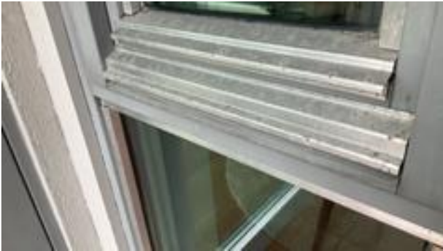
Oppsprikning/værslitasjer på enkelte vinduer.
