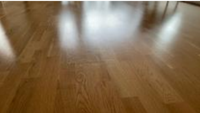
Enkelte skraper/bruksslitasjer på parkett.
