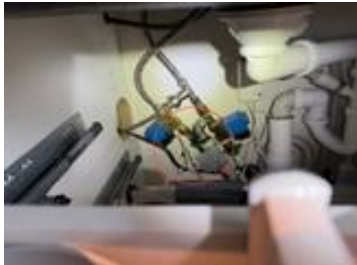
Viser manglende tettemuffer på rør i rør system i kjøkkenbenken.
