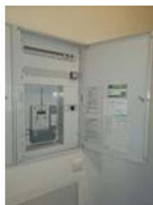
Sikringsskap med automatsikringer og kursfortegnelse
