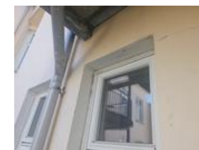
Sprekk i fasaden
