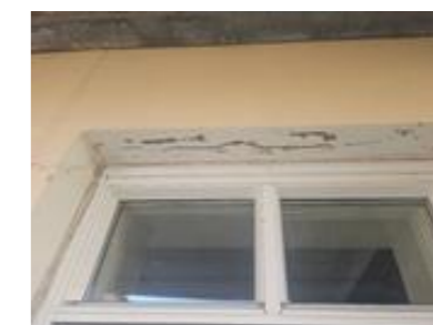
Trolig rustsprenging fra jernbjelke over vindusåpning
