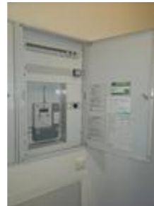
Sikringsskap med automatsikringer og kursfortegnelse
