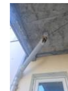
Rust på nedløpsrør fra veranda 3 etg skyldes trolig at nedløp av zink er festet med ståltråd. Ikke synlig lekkasje men bør utbedres.
