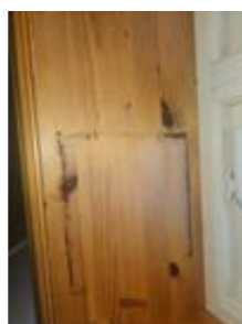
Svart merke i underkant av vinduet på kjøkkenet
