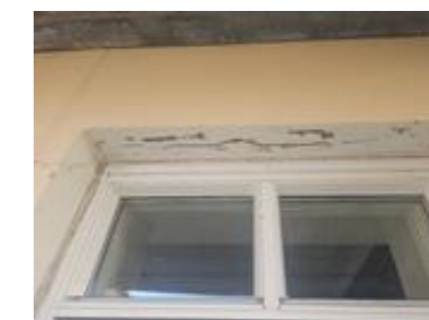
Trolig rustsprenging fra jernbjelke over vindusåpning
