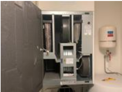
Balansert ventilasjon med varmegjenvinner
