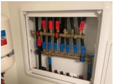
Fordelingsskap for tappevann
