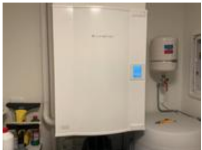
Balansert ventilasjon med varmegjenvinner
