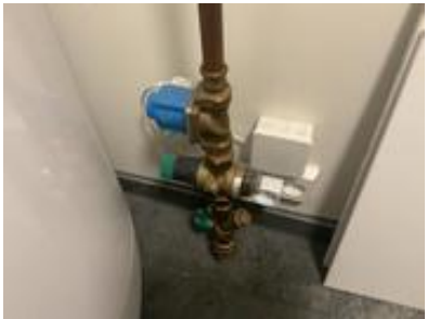
Stoppekran og reduksjonsventil for vann
