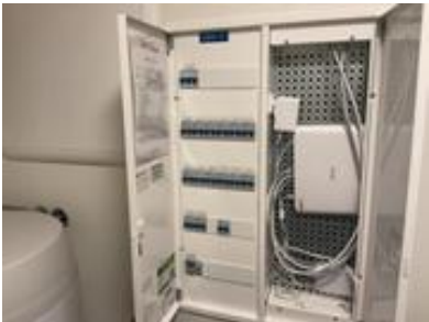
Sikringskap med automatsikringer og kursfortegnelse
