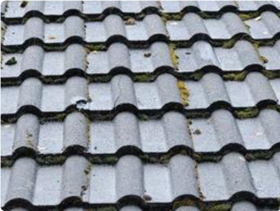
Skadet takstein på østsiden av boligen.
