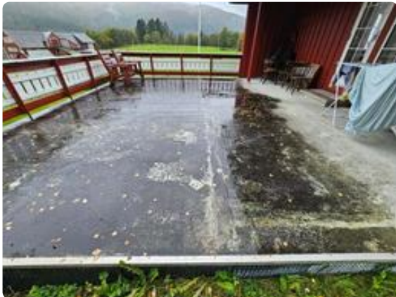
Synlig skjøl på betongdekke. Noe vannansamling på eldre betongdekke til høyre i bildet. .
