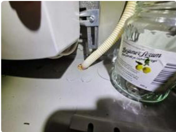
Hull i sikringsskap som ikke er forskriftsmessig tettet.
