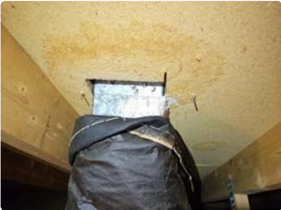
Ventilasjonskanal med manglende isolasjon som utgjør kondens/fuktmerker i undertak.
