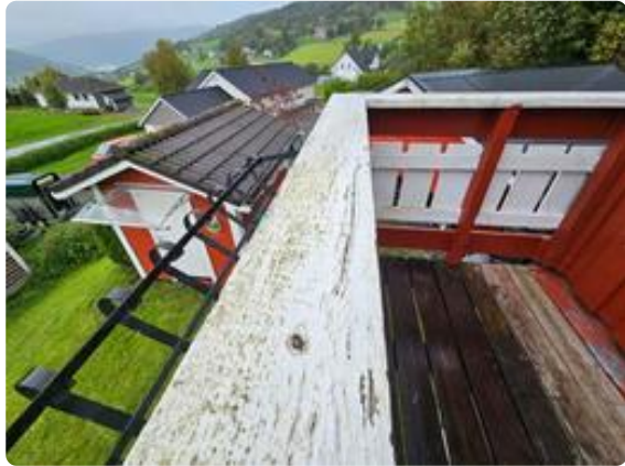
Slitasje på overflater balkong ved soverom.
