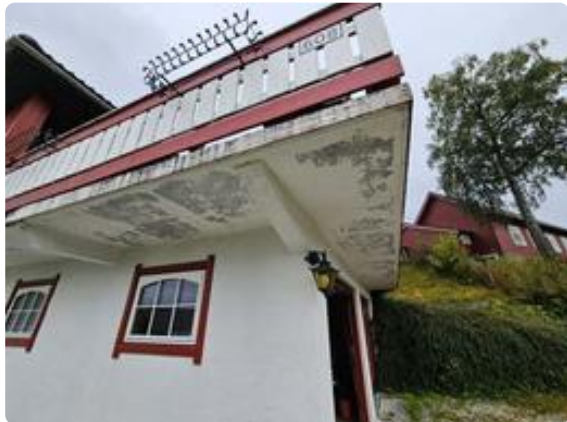
Malingflass på undersiden kan indikere fukttransport gjennom betongdekke.
