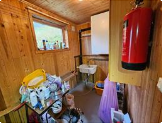
Trepanel på vegg, med belegg på vegg ve vask. Anbefaler oppgradering av overflater før utvidet bruk som våtrom.
