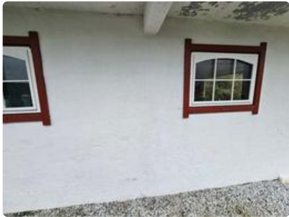
Riss i pussten i overgang mellom eldre bygg og tilbygg ved garasje.
