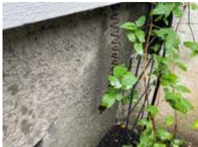
Musebånd bak kledning har rust/korrosjonsskader samt henger løst på den ene plassen.
