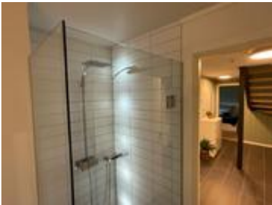
Innvendig dør er plassert i våtsone for dusjinisje.
