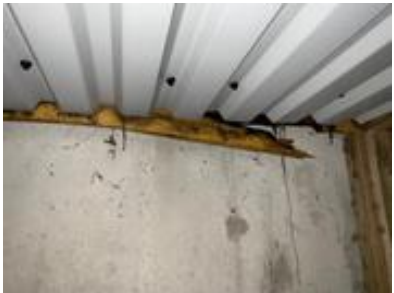
Råteskade i nederste kledningbord bak terrasse.
