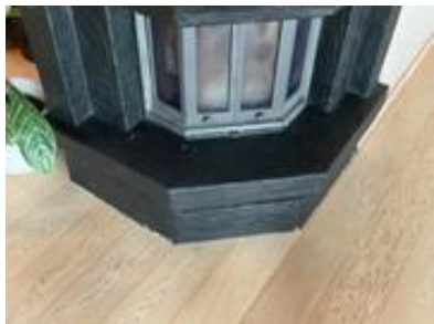
Det er ikke montert ildfast plate på gulv foran ovn i stue.
