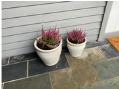
Liten avstand kledning/platting ved inngang.
