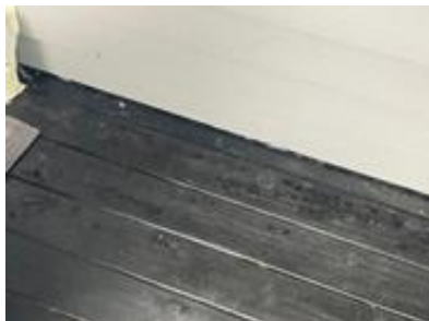
Liten avstand kledning/terrasse.
