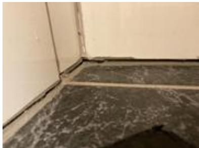
Riss/sprekker i silikonfuge
