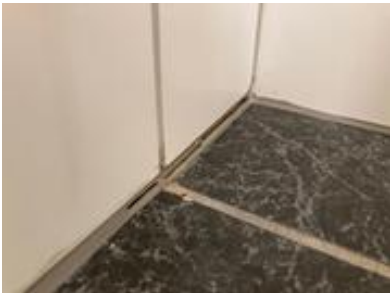
Riss/sprekke i silikonfuge
