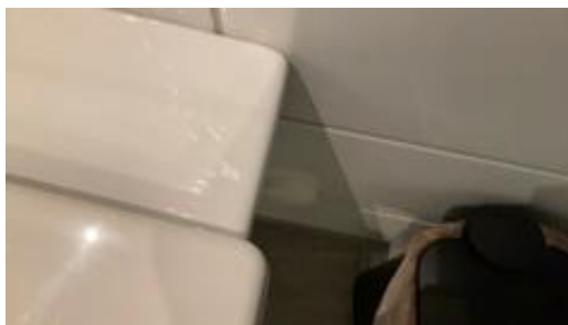
Drensåpning fra skjult susterne på toalettassen
