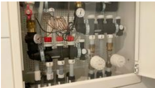
Kurser for vannbåren varme, 3 stk.
