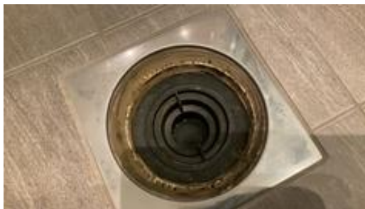
Sluk i gulv.
