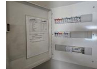
Sikringskap med automatsikringer og kursfi
