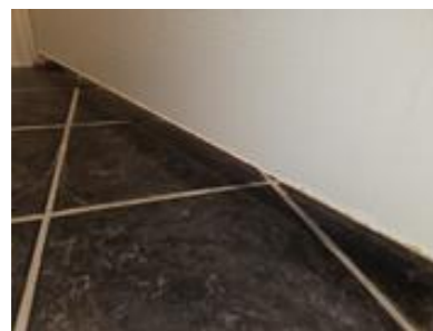
Skade på nedre kant av dørbladet, dør mot bad
