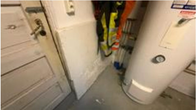
Synlig brannfarlig isolasjon
