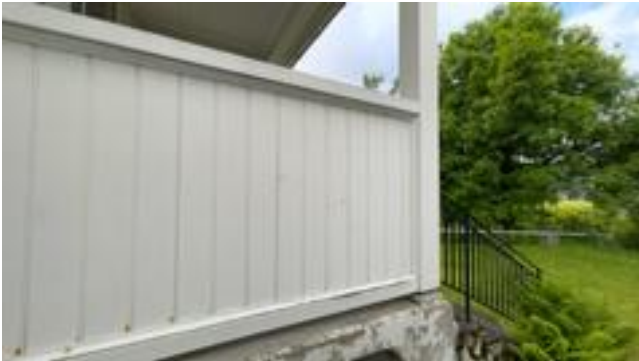
Værslitt trevirke og bruk av spiker som ruster
