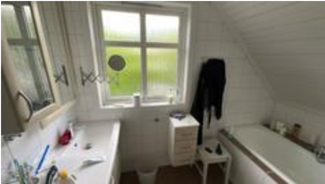
Det er skrå himling og vindu i våtsone
