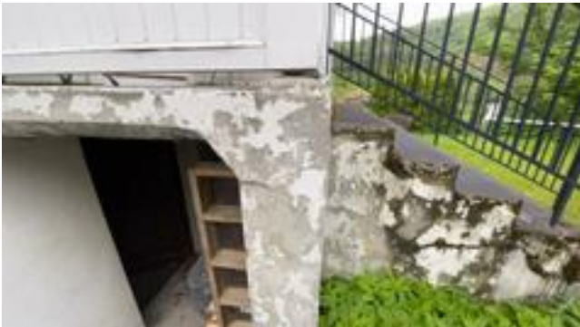
Værslitt og sprekker i betong
