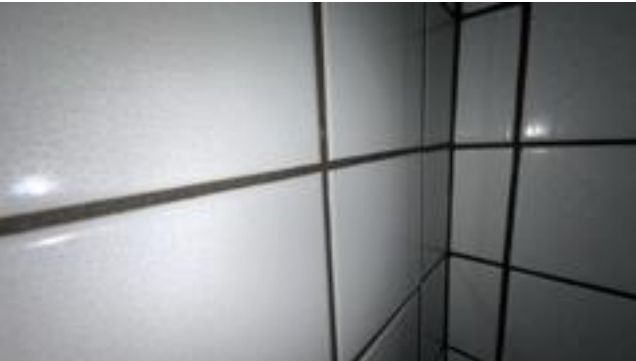
Mindre avvik i fuger er observert.
