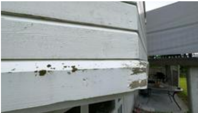
Stedvis værslitt kledning.
