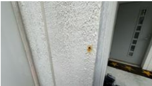
Rustne festemidler observert
