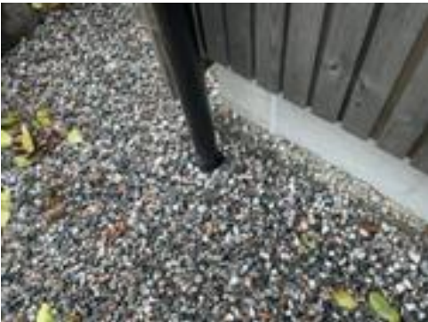
Takvannet ledes til rør i grunnen
