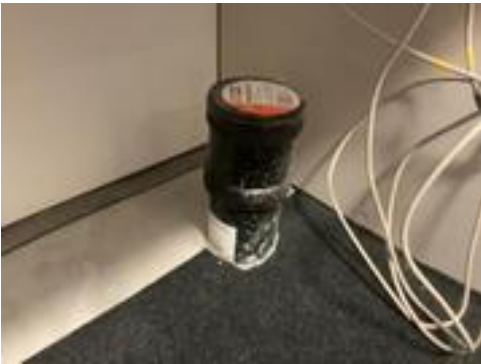
Rør fra radonbrønn stikker opp i kjelleren
