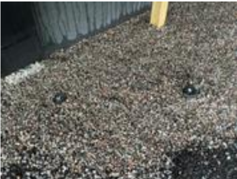
Utvendig stoppekran og stakepunkt.
