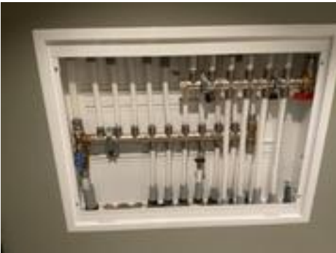
Fordelingsskap for tappevann
