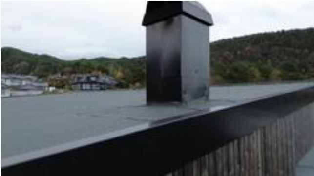
Pipetrekk av metall
