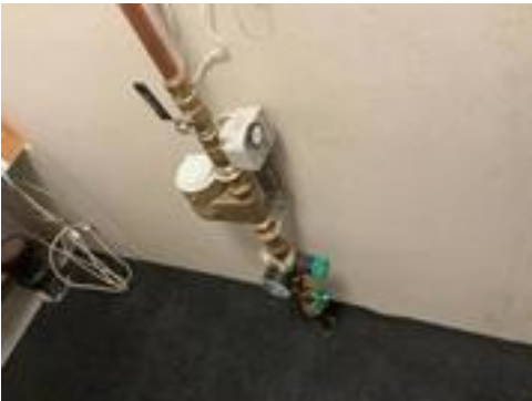
Stoppekran, reduksjonsventil og måler for vann
