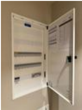
Sikringsskap med automatsikringer og kursfortegnelse
