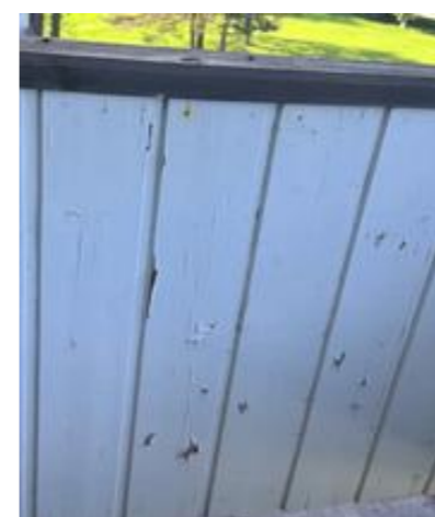
Eksempelbilde av slitasjegrad på rekkverk.
