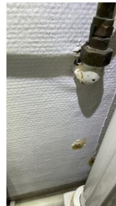
Eksempelbilde av utett rørgjennomføring.
