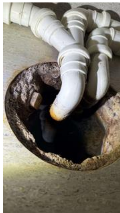
Eksempelbilde av utett løsning ved sluk.
