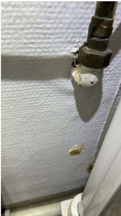
Eksempelbilde av utett rørgjennomføring.
