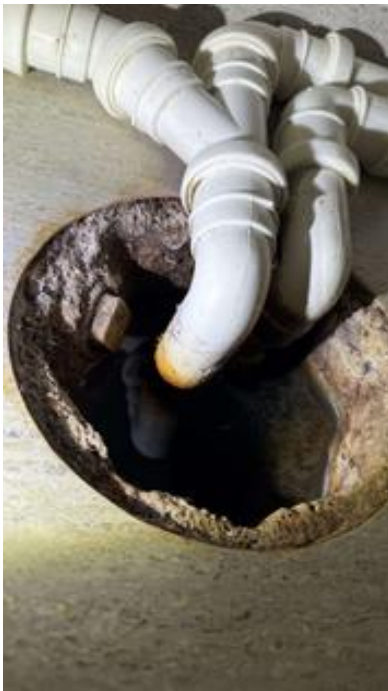
Eksempelbilde av utett løsning ved sluk.
