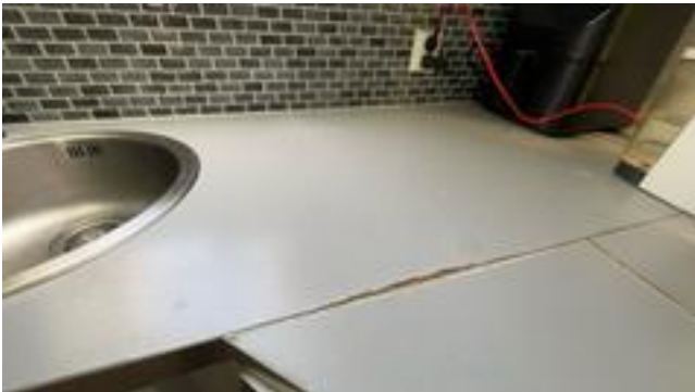
Benkeplate er skadet
