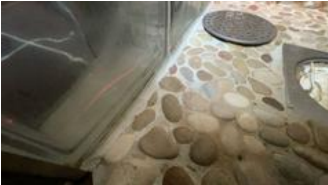
Sprekker i silikolfuger
