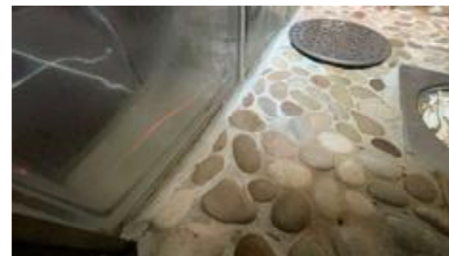
Sprekker i silikonfuger
