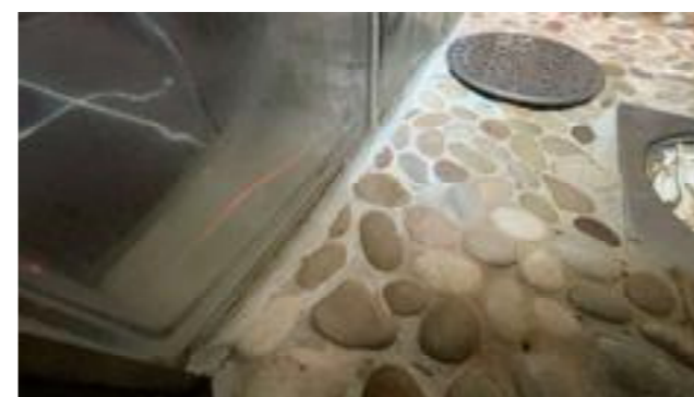
Sprekker i silikonfuger
