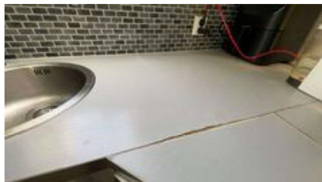
Benkeplate er skadet
