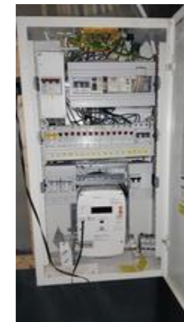
Elektrisk anlegg - [Sikringsskap hoveddel]
