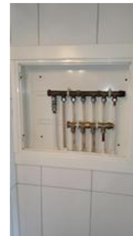
Elektrisk anlegg - [Fordelerskap leilighet]
