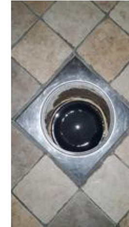
Våtrom - [Sluk bad 1. etasje]
