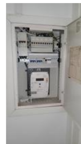
Elektrisk anlegg - [Sikringssskap leilighet]
