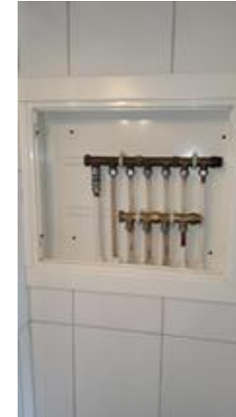
Tekniske anlegg, VVS anlegg (Sjekkpunkter utover det som er inkludert i andre rom) - [Fordelerskap leilighet]
