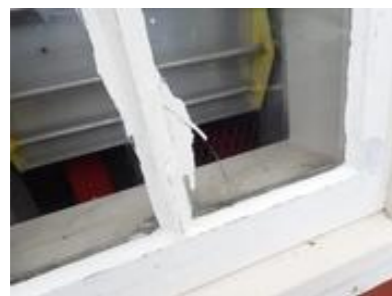
Eksempel på værslitte vinduer og sprukket glass på garasje.
