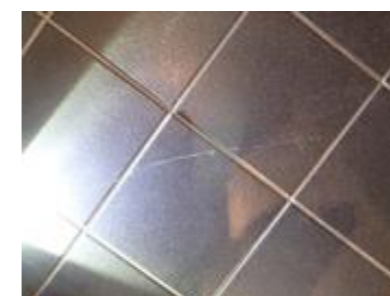
Eksempel på riss/sprekk i gulvfliser.
