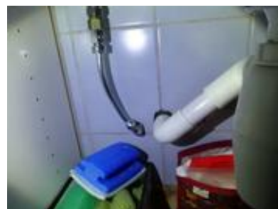
Utett rørgjennomføring i vegg under servant.
