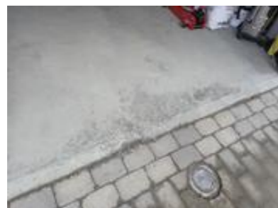
Lokal avskalling på støy og rustspreng i front ved garasjeport.
