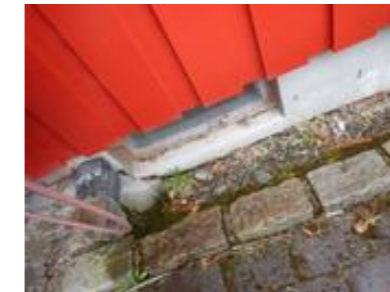
Eksempel på deler av eldre drenering med manglende topplist over grunnmursplast.
