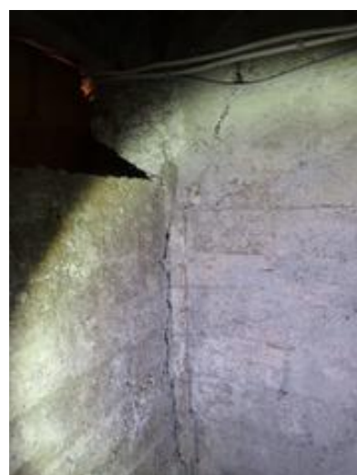
Sprekk i grunnmur i rom benevnt som bod/trapp.
