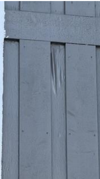
Eksempelbilde av blæring og malingsavflass.
