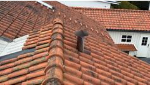
Takhatt bør byttes (rust)
