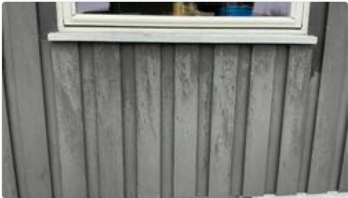
Svertesopp på kledningen.
