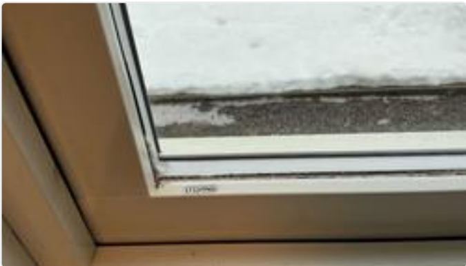
Begynnende soppvekst i vindu på bad.
