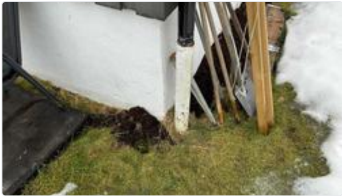
Rust på eldre nedløp.
