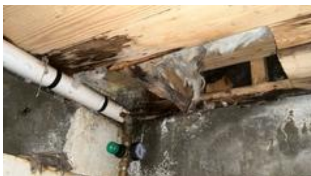
Fukt- og råteskade i hjørne mot sørvest over krypkjeller.
