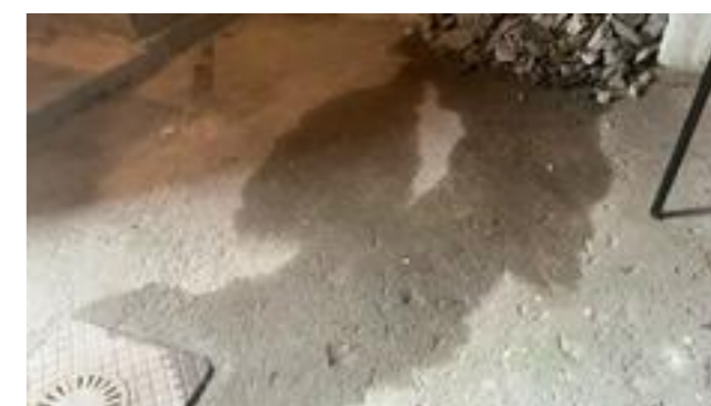
Fuktsig fra krykkjeller
