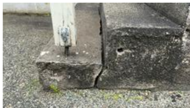
Støpt trapp har sprekk ved trinn.
