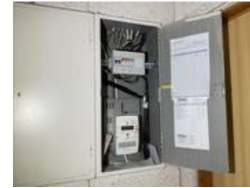
Skap i felles trappegang.
