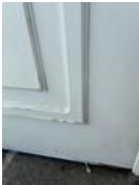
Værslitt overflatebehandling på ytterdør
