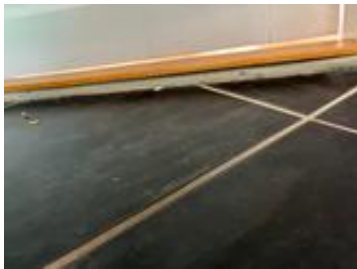
Registrert oppbrett av membran ved dørterskel
