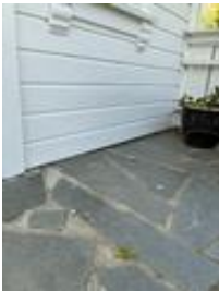
Lav avstand til terreng, begrenset lufting
