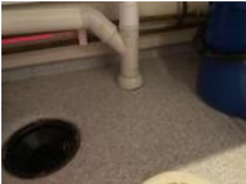
Rørgjennomføringen under servanten
