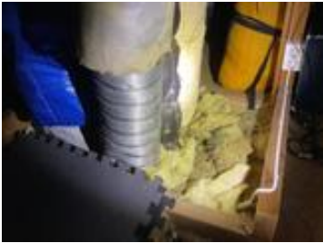
Delvis manglende isolering av ventilasjonsrør.
