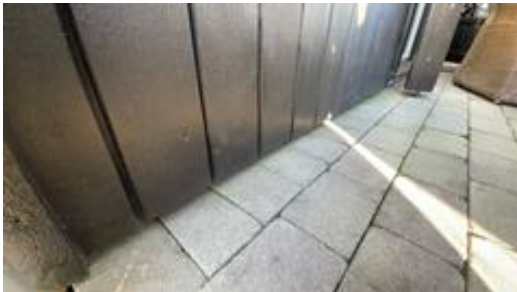
Liten avstand kledning/terreng på side med inngangsparti.
