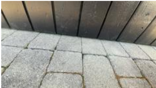
Liten avstand kledning/terreng på langside.
