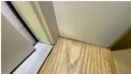
Fuktsvelling i nedre kant av foring til terrassedør.
