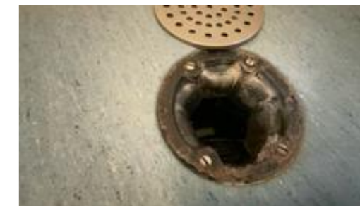
Sluk i gulv med vinylbelegg som tettesjikt.
