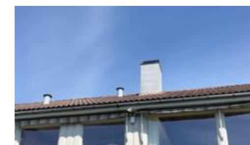
Det er ikke montert snøfangere på tak.
