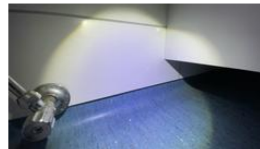
Plater er ikke montert på bunnskinne i våtsone for innredning.
