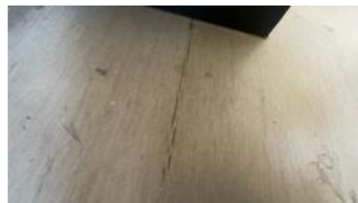
Sprekker i sveist skjøt på gulv.
