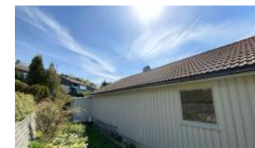
Det er ikke montert stigetrinn på tak.
