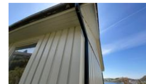
Nedløpsrør mangler veggfester.
