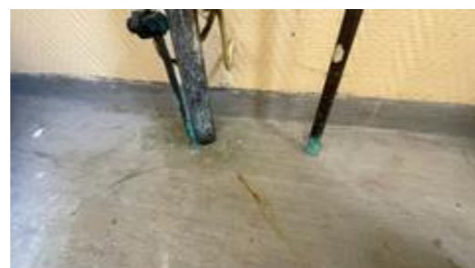
Ikke tilstrekkelig oppbrett av vinylbelegg rundt gjennomføringer for rør.
