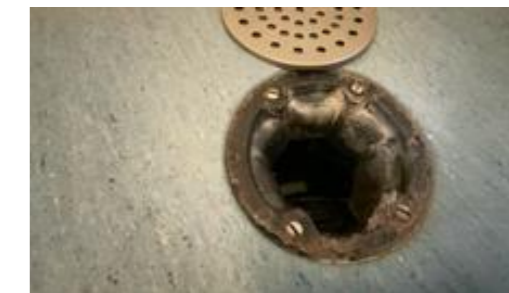
Sluk i gulv med vinylbelegg som tettesjikt.
