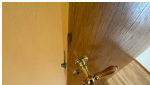
Skade i kant av dørblad til soverom i 1. etasje.
