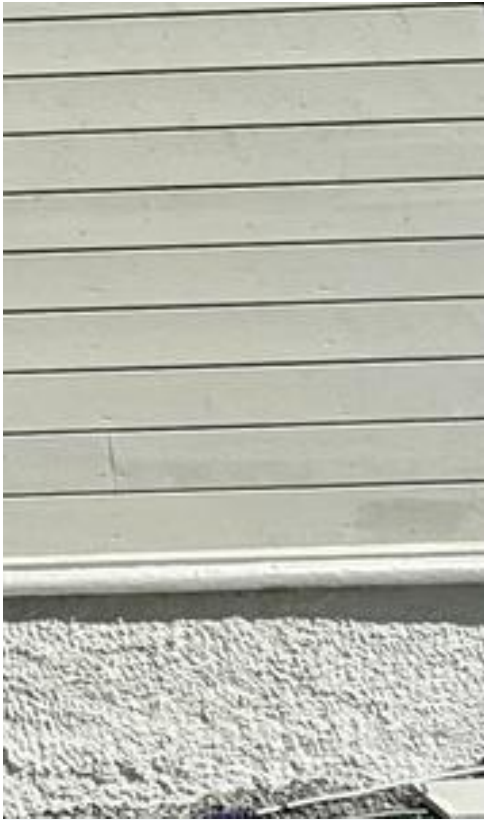
Manglende luftespalte mot sylstokk.
