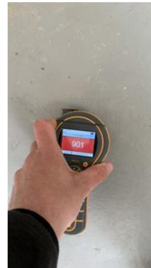
Fuktsøk i kjellergulv viser indikasjoner på fukttransport/ kapillært opptrekk.
