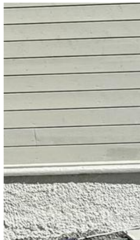
Manglende luftespalte mot sylstokk.
