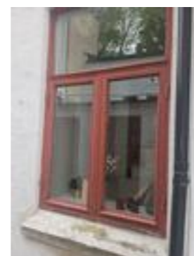
Vinduene mot bakgården er slitte
