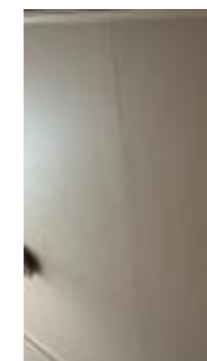
Sprekk i himlingen over soverommet
