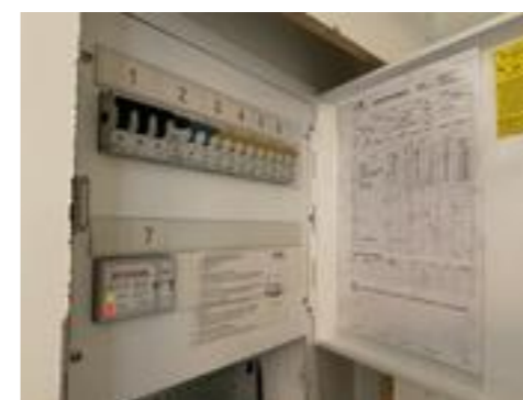
Sikringsskapet i hybelen
