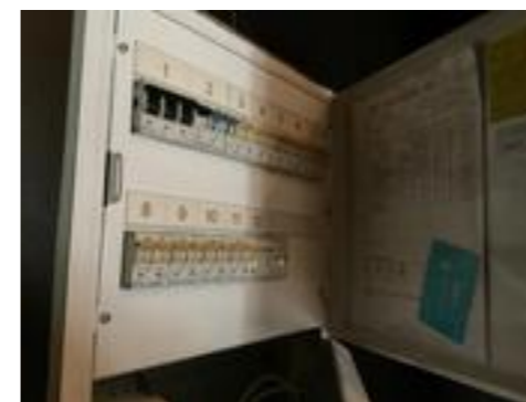
Sikringsskapet i hoveddelen
