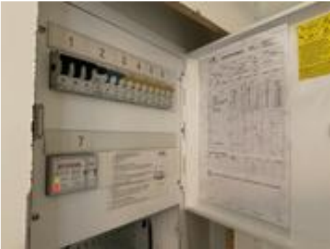
Sikringsskapet i hybelen
