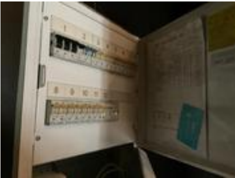
Sikringsskapet i hoveddelen
