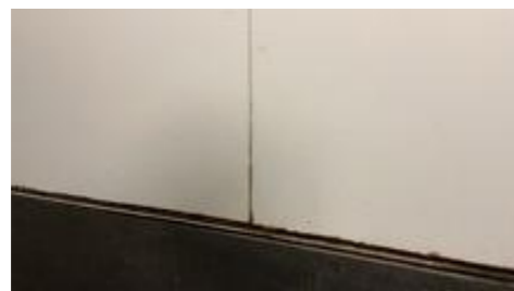
Svelling og missfarging i baderomsplate i dusj
