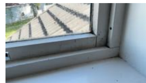
mugg/begroing i vindu 2. etg
