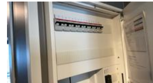
Sikringskap med automatsikringer.
