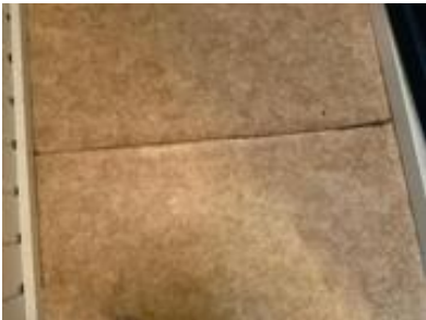
Skade i beleggsjøt på gulv i gang i kjeller.
