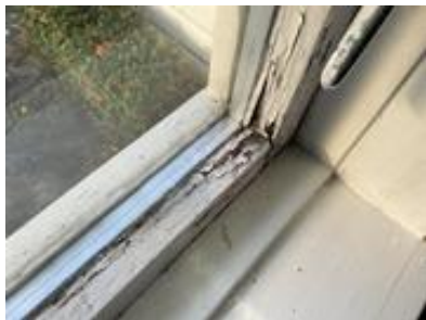
Noe råte i innvendig karm til vindu i soverom 1. etasje.
