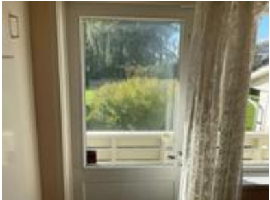
Punkttert glass i balkongdør i soverom.
