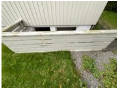
Rekkverk rundt trapp er for lavt iht. krav i dagens forskrifter.
