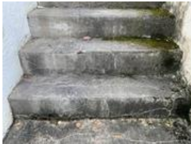
Riss/sprekker i utvendig betongtrapp.
