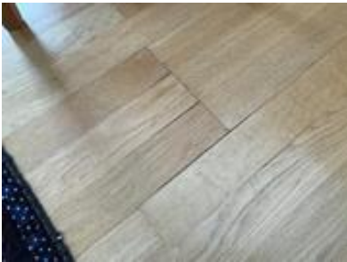
Fuktskade i parkett i stue.
