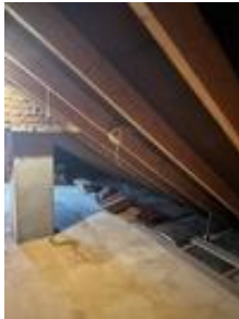
Sutaksplater montert med oppsiden ned (feil veg)
