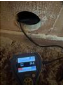
Målt høy fuktighet i kjellerstue.
