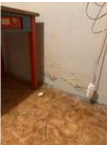
Saltutslag/fukt på mur i bod innenfor vaskerom.
