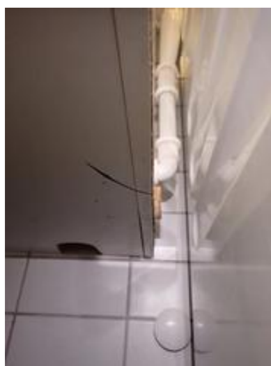
Fuktskade på nedre del av innredning mot vaskemaskin.
