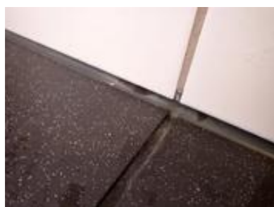
Det registreres misfarget silikonfuge i overgang gulv/vegg.
