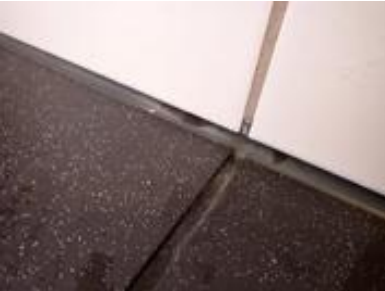
Det registreres misfarget silikonfuge i overgang gulv/vegg.
