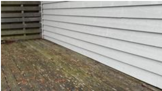
Nyere kledning i kontakt med terrassegulv.
