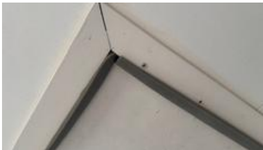
Loftsluke er skrudd fast, loft er ikke tilgjengelig uten bruk utstyr.
