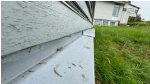
Det er ikke tilrettelagt med lufting bak kledning.
