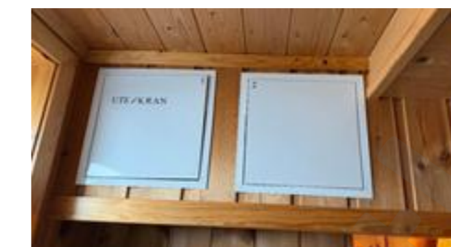
Rørskap i bod uten lekkasjesikring og avrenning.
