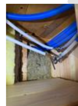
Rørskap i bod uten lekkasjesikring og avrenning.
