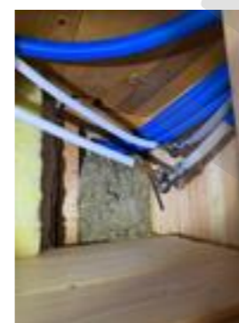
Rørskap i bod uten lekkasjesikring og avrenning.
