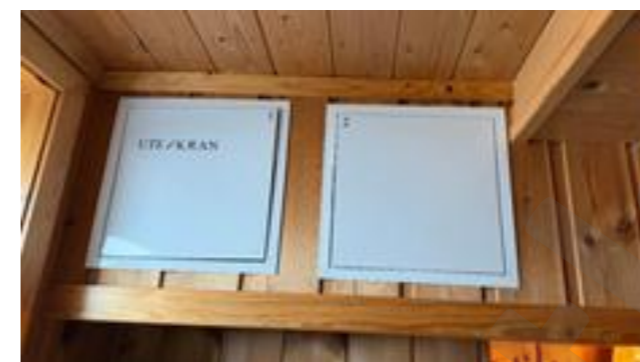
Rørskap i bod uten lekkasjesikring og avrenning.
