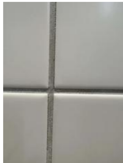
Eksempel på riss/sprekk i flisfuger på vegg i dusjsonen.
