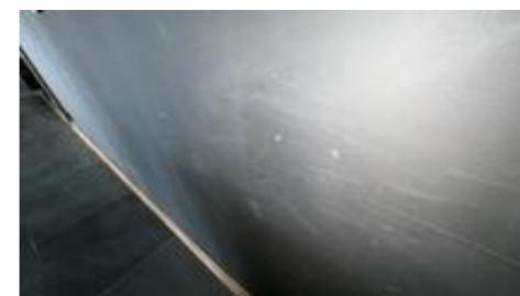
Enkelte overflater har noe riper.
