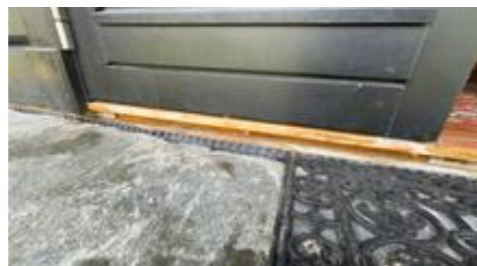
Det er ikke montert beslag under enkelte dører.
