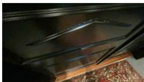
Det er observert noe avvik i overflaten på dørbildet på ytterdør og garasjedør.
