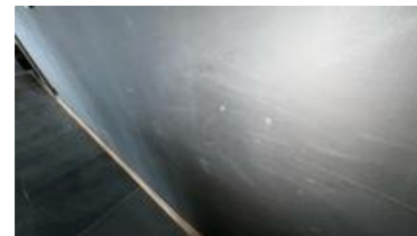
Enkelte overflater har noe riper.
