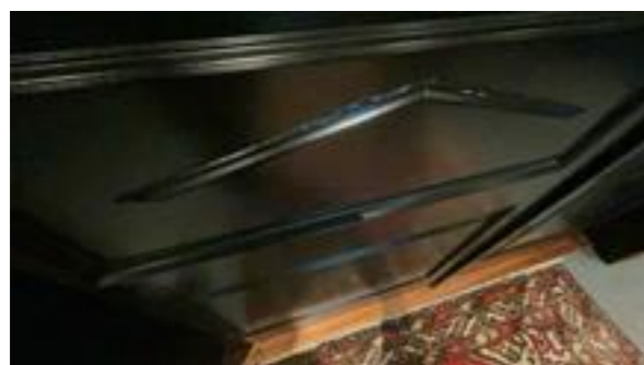
Det er observert noe avvik i overflaten på dørbladet på ytterdør og garasjejør.
