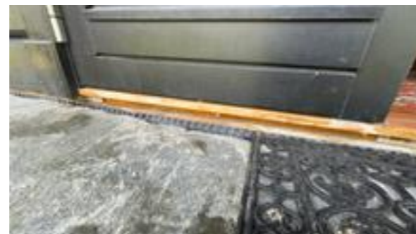
Det er ikke montert beslag under enkelte dører.
