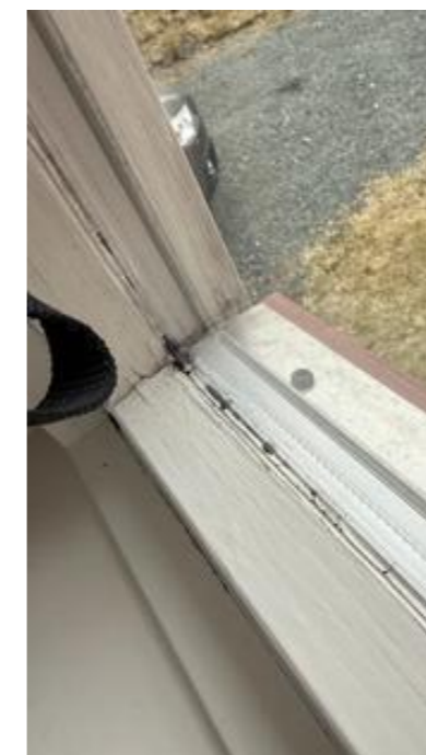
Eksempelbilde av slitasjegrad til vinduer i tilbygg.
