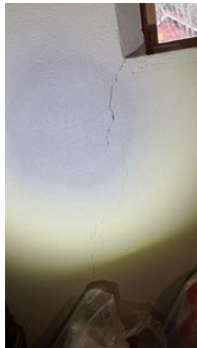
Eksempelbilde av riss/ sprekk i grunnmur.
