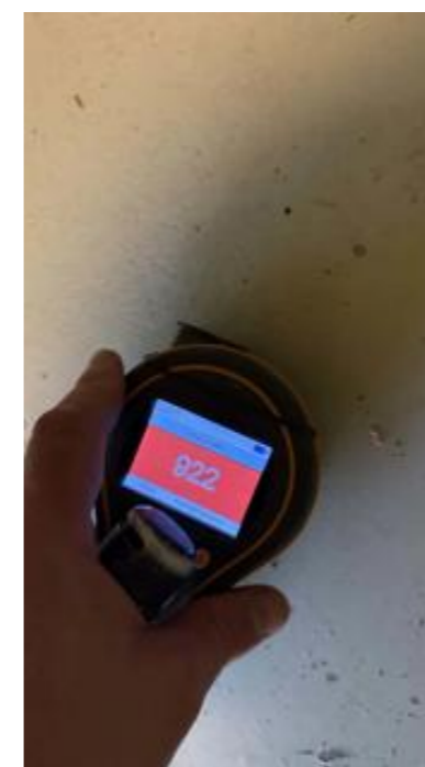
Eksempelbilde av fuktsøk og indikasjoner på fuktgjennomgang i støpt gulv mot grunn.
