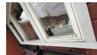
Eksempelbilde av slitasjegrad på vinduer ved terrasse med takoverbygg.
