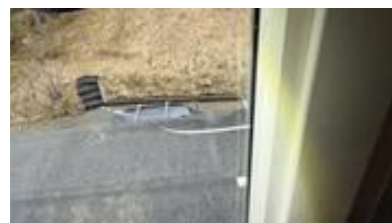
Eksempelbilde av sprekk i glass på soveromsvindu.
